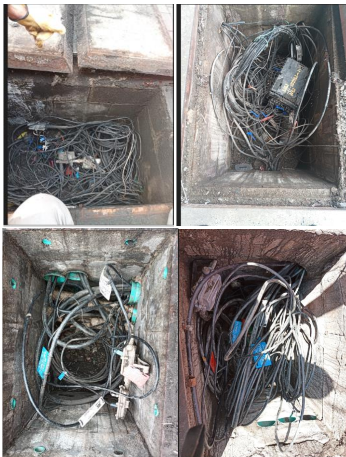
Figura 5. Imágenes de infraestructura de propiedad de TIGO alojando equipos de terceros.
